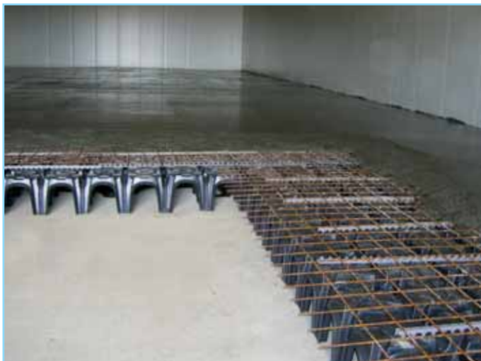
Рис. 16) г.Реджо-Эмилия • Холодильный склад 6240 кв.м.
